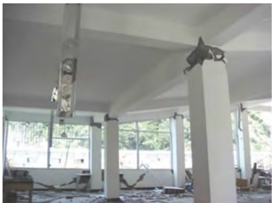
图6 钢筋混凝土结构地震破坏(中国四川)
