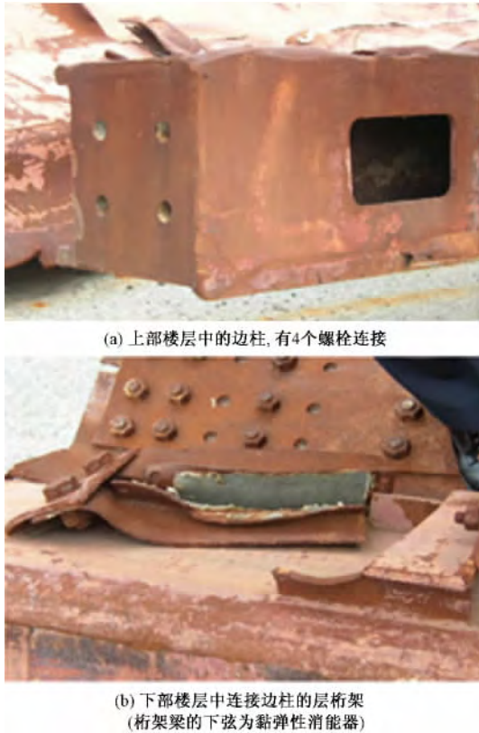
图7 世界贸易中心中破坏的钢框架
