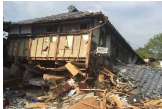
熊本地震中木结构建筑的破坏 摄影: 和田 章
