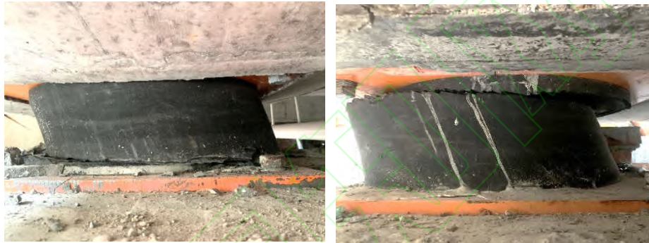
图6 铅芯橡胶支座的残余变形和断裂（拍摄：柏文）
