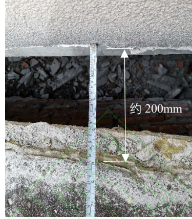
b) 隔震缝盖板沿 y 方向残留的缝隙
