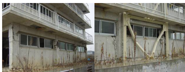
(a) 未加固教学楼的震害 (100% JMA Kobe) (b) 加固后教学楼在正弦波激励下的震害
