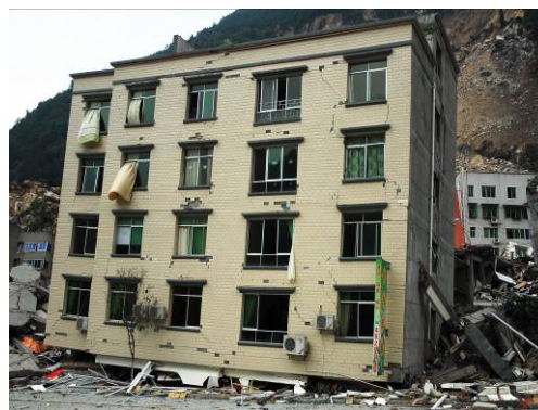
(b) 北川某底框住宅底层倒塌 (b) Collapse of the first story
