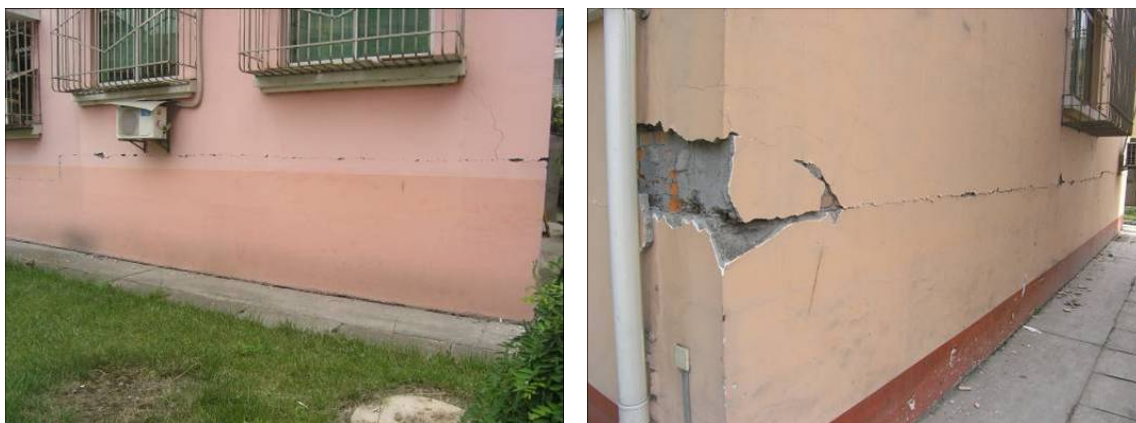
图1 汶川地震中绵竹某砌体结构房屋的底部水平裂缝(李爱群)
